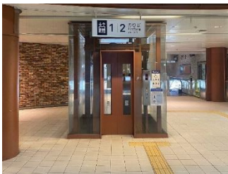
エレベーター
