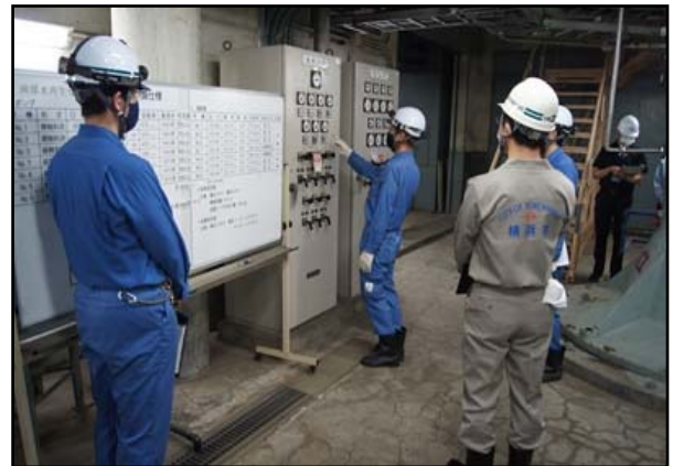
ポンプ設備の運転訓練
